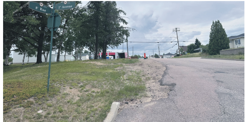
Des travaux de réfection des systèmes d'aqueduc et d'égout auront lieu dans la 8 e rue et la 4 e Avenue à Forestville. Photo Johannie Gaudreault
