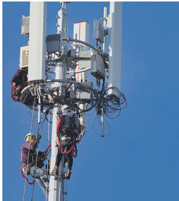
La Côte-Nord sera munie de 10 nouveaux sites de télécommunication grâce aux investissements de TELUS. Photo Pixabay
